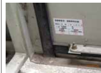
増し締め確認シール
