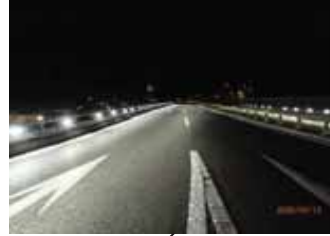
Aランプ 低位置照明 橋梁高欄部取付
