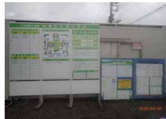
安全看板設置
