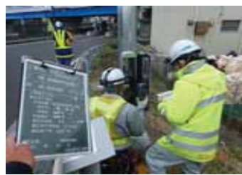
電圧降下測定 (現地側)
