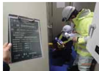
端子電圧測定
