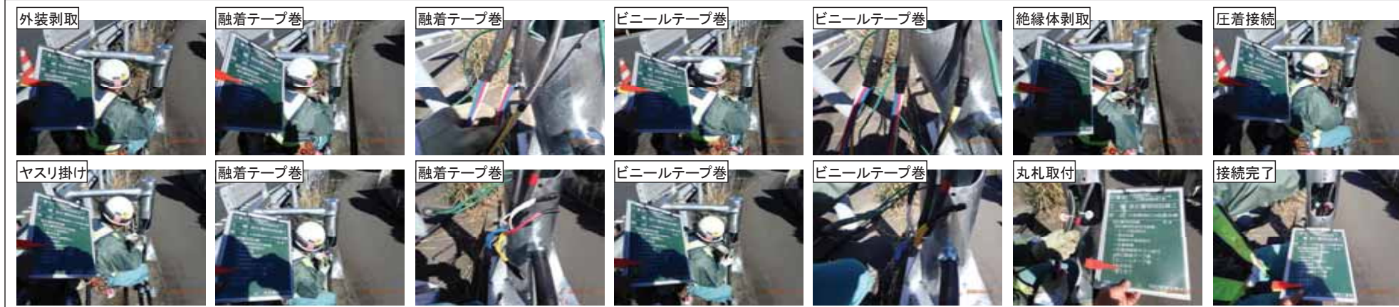
低位置照明支柱内結線
