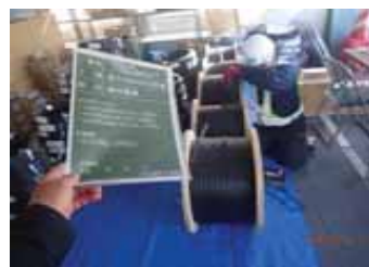
絶縁抵抗試験 (搬入時)
